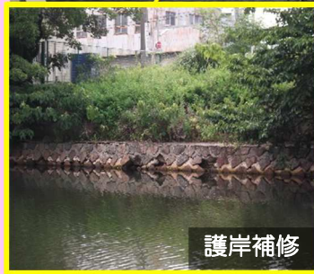
護岸の老朽化対策
