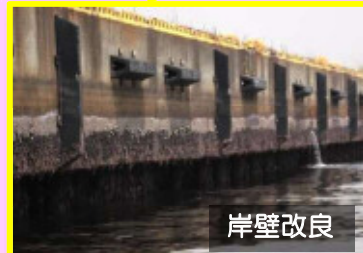
岸壁の老朽化対策
